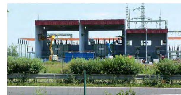
The transformer station - 110/22 kV / transformátorová stanice - 110/22 kV
