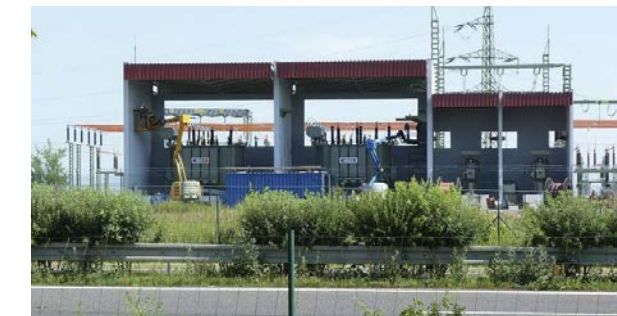
The transformer station - 110/22 kV / transformátorová stanice - 110/22 kV
